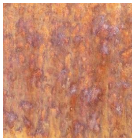
80 dias de exposição Grau D corrosão e pites
